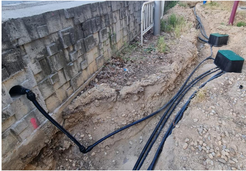
Imagen de la excavación de zanjas para red de tuberías de reparto de riego
