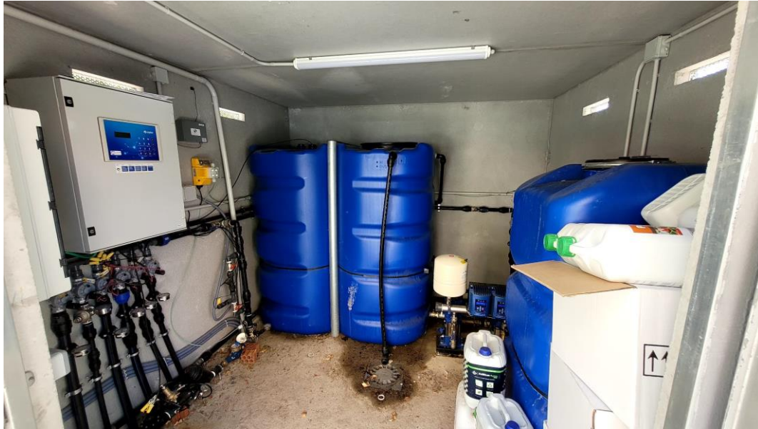
Interior del local técnico instalado en superficie (armario de control, depósitos, árbol de electroválvulas y bombas de impulsión)
