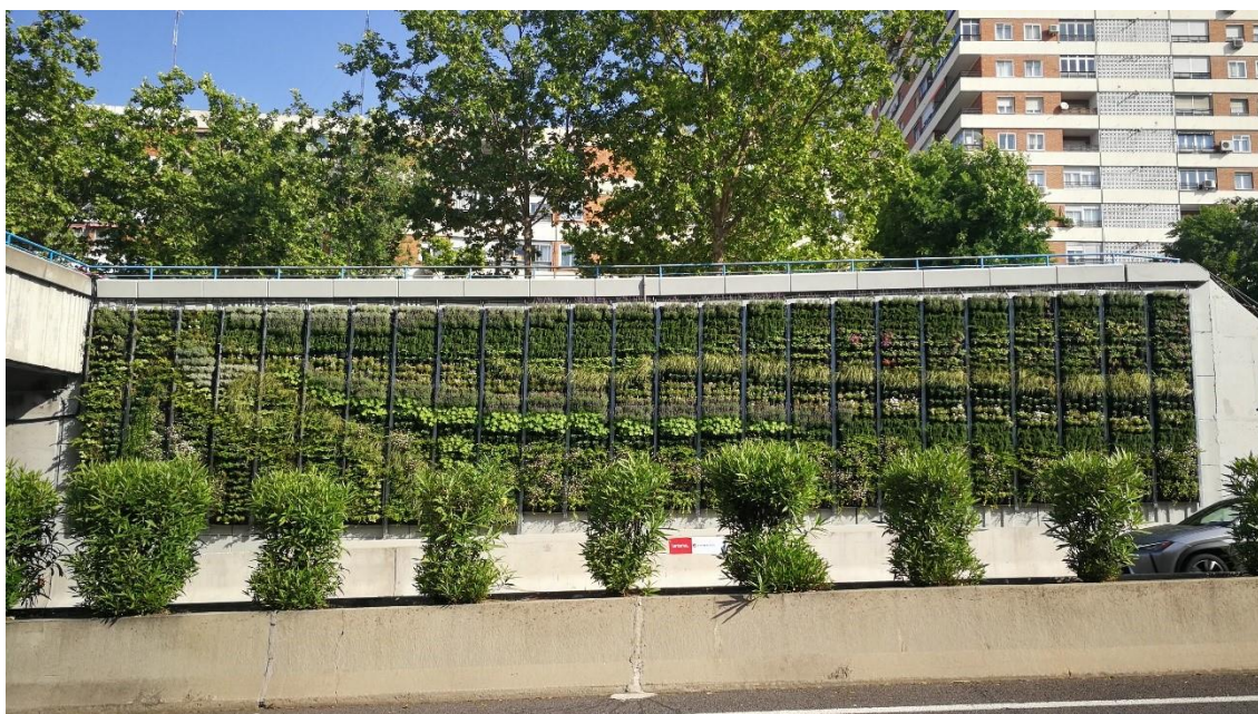
Sistema de jardín vertical ya instalado
