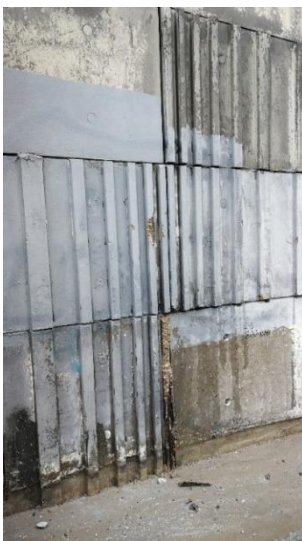
Patología de muro en zócalo
